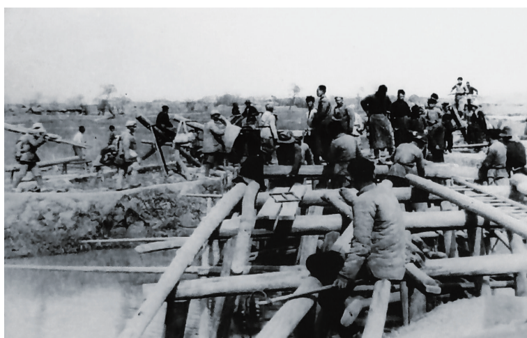
各地群众为南进大军筑路修桥，这是群众正在扬州、六合公路上修建桥梁。
